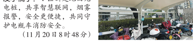
慈溪客户端“慈圈”圈友小橘子：小区新建地面充电桩，共享智慧联网，烟雾报警，安全更便捷，共同守护电瓶车消防安全。 (11月20日8时48分)
